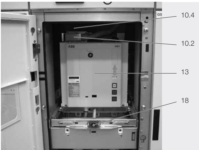
Bild 3/5: Leistungsschalterbereich, Schaltfeld der Klassifizierung LSC 2A - PI, Fronttür geöffnet, Leistungsschalter-Einschub VM1 in Betriebsstellung. 10.2 Steuerleitungsstecker 10.4 Ablage für Steuerleitungsstecker 13 Schaltereinschub mit Leistungsschalter VM1 18 Spindeltrieb Einschub
