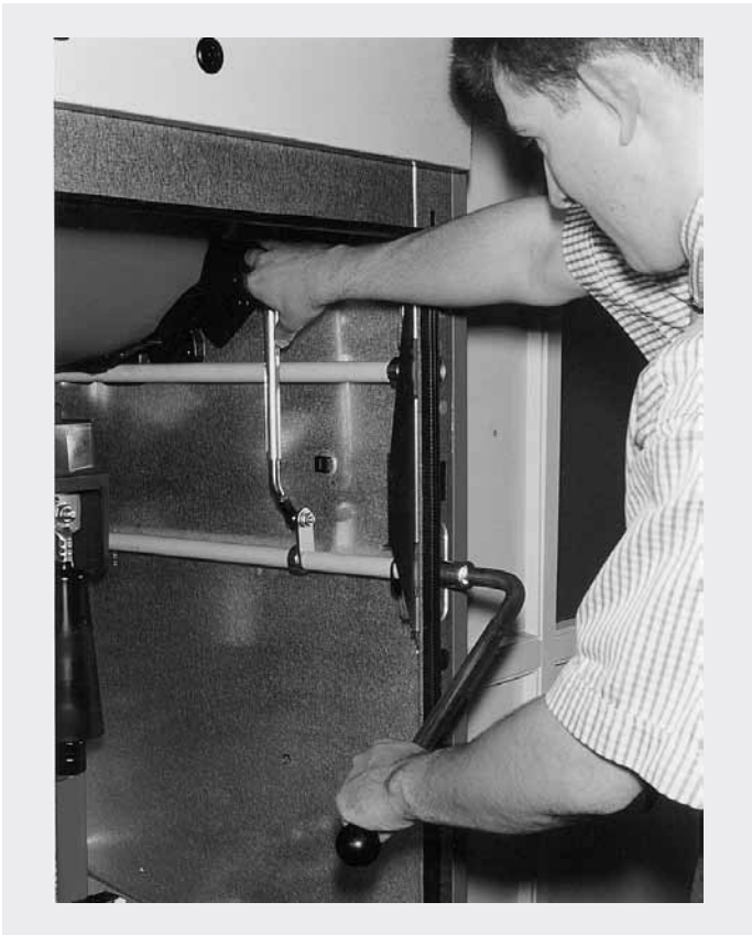
Bild 6/12: Lasttrennschalterfeld, Aufheben der Verklammerung mit Hand am Beginn des Entriegelungsvorganges sowie beim Ausschalten des Erdungsschalters bei eingeschobener automatischer Schiebepalette. Schaltfeld ohne Abweigschottung.
