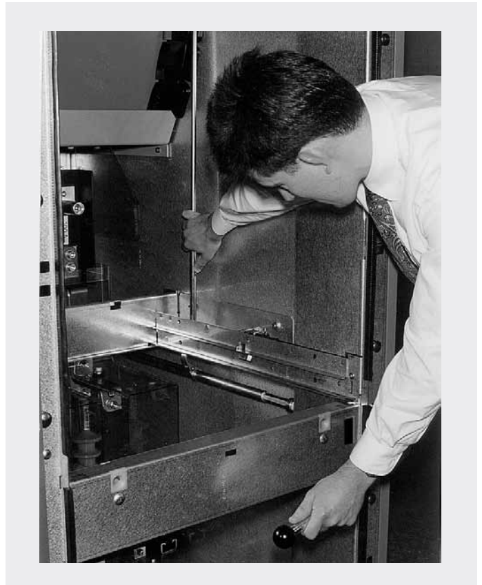
Bild 6/13: Leistungsschalterfeld ohne Schaltereinschub, Aufheben der Verklammerung analog wie bei Bild 6/12. Schaltfeld ohne Abweigschottung.
