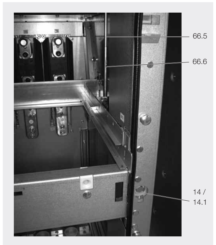
Bild 3/14: Verbindung zwischen Antrieb Erdungsschalter und automatischer Schiebeplatte für Schaltfeld der Klassifizierung LSC 2A - PI.
