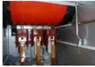
Schiebeplatte am Ende der Schaltbewegung - Erder EIN
