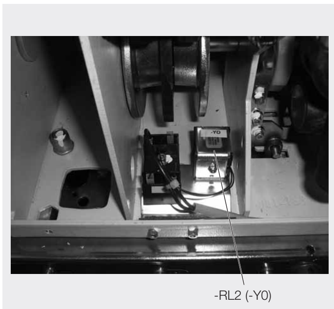
Bild 7/6: Handverfahbarer VD4-Einschub, Frontplatte abgenommen. -RL2 Sperrmagnet für Einschub
