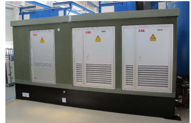
[ABB Brilon, Mittelspannungslängsregler 20 kV / 8 MVA]
