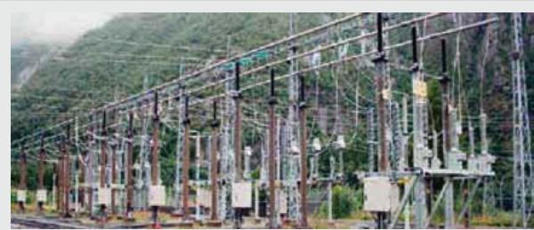
รูปที่ 5 เรื่องความสำเร็จ – สถานีไฟฟ้าย่อยใน Grytten ของ Statnett
