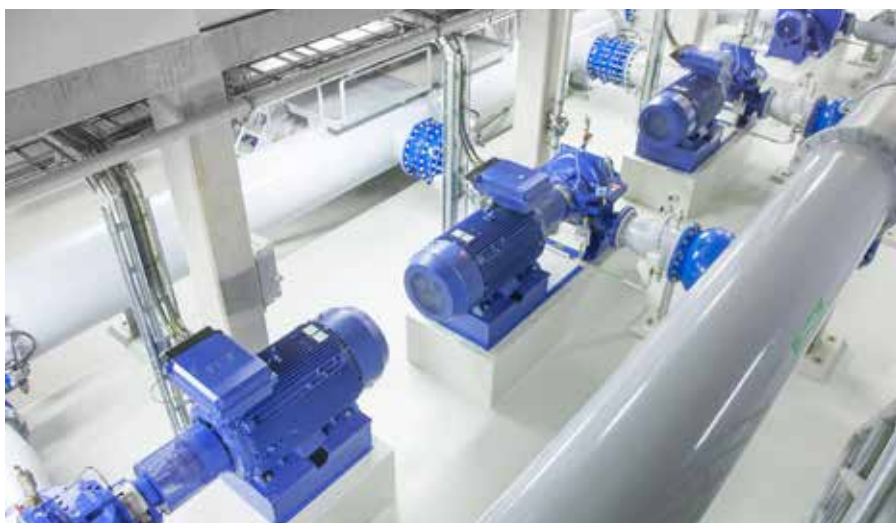
Figura 2. Evides Waterbedrijf ha utilizado paquetes de impulsión y bomba SynRM instalados alcanzando un ahorro de energía estimado en un 20 %.
