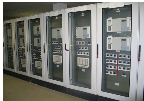
Шкафы защиты и управления 500 кВ
