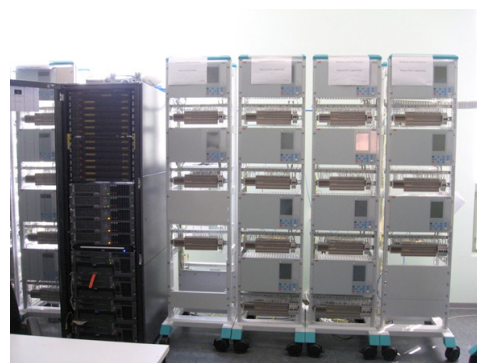
Испытательный полигон АСУ – 61850 в г. Чебоксары
