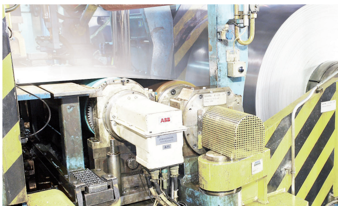
Instalace Stressometer ve válcovně nerezové oceli
