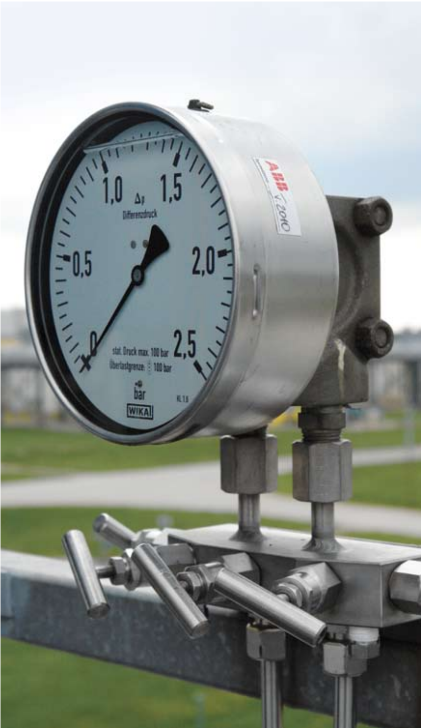
Tłocznie na „Jamale” zostały wybudowane przez ABB. Teraz firma będzie serwisować systemy pomocnicze i automatykę. (Fot. Arch. ABB)
