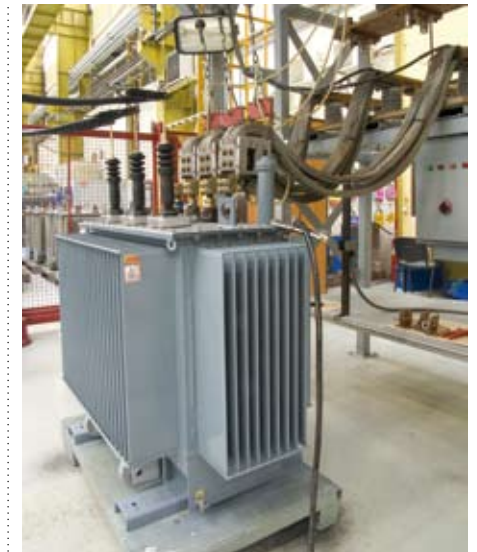
Grupa TAURON zdecydowała się na zakup transformatorów rozdzielczych z rdzeniem amorficznym, stawiając przede wszystkim na energooszczędność. (Fot. Andrzej Gabler/Arch. ABB)
