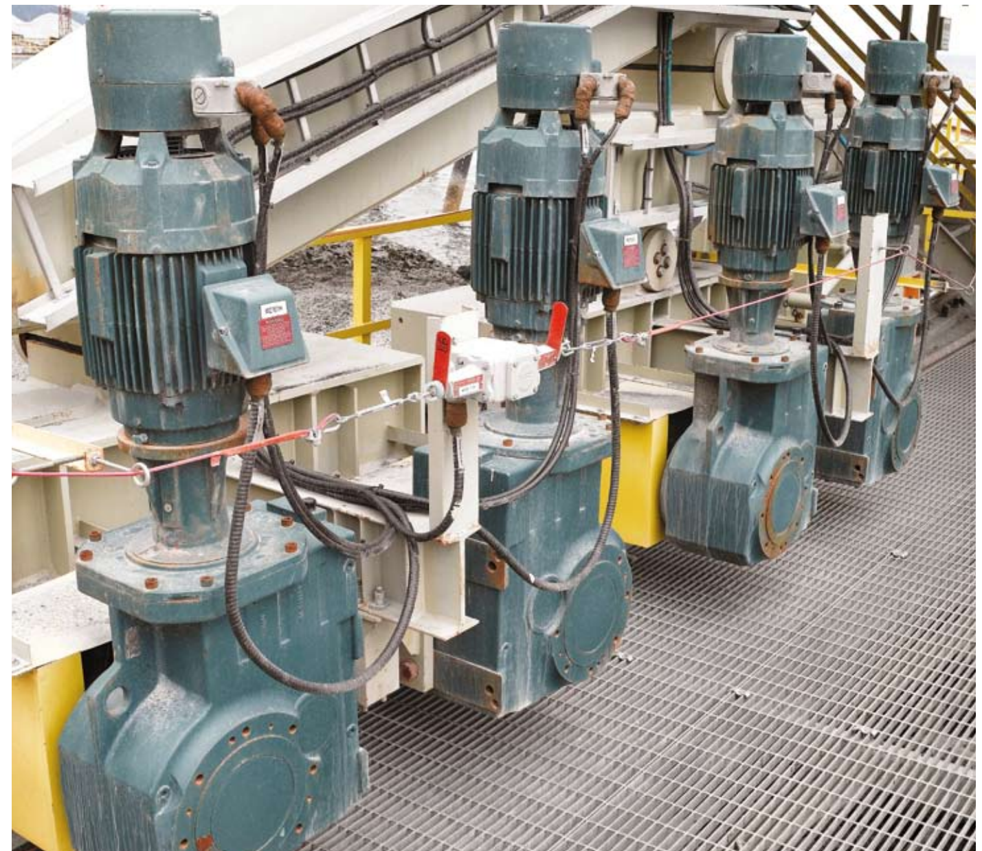
Przekładnia kąto- wa stożkowa o zębach śrubowych (RHB) Quantis napędza napęd obrotowy przenośnika wyładunkowego wapienia. Produkty z linii Quantis obejmują efektywne energetycznie, modułowe przekładnie, w skład których wchodzi również przekładnie równoległe stożkowe (ILH) i motoreduktory (MSM). (Fot. Arch. ABB)
