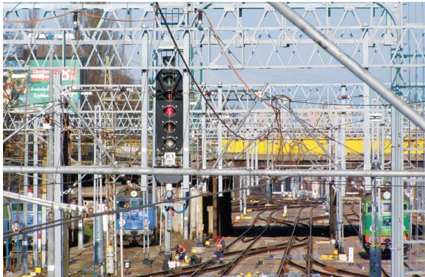
(Fot. PKP Energetyka)
