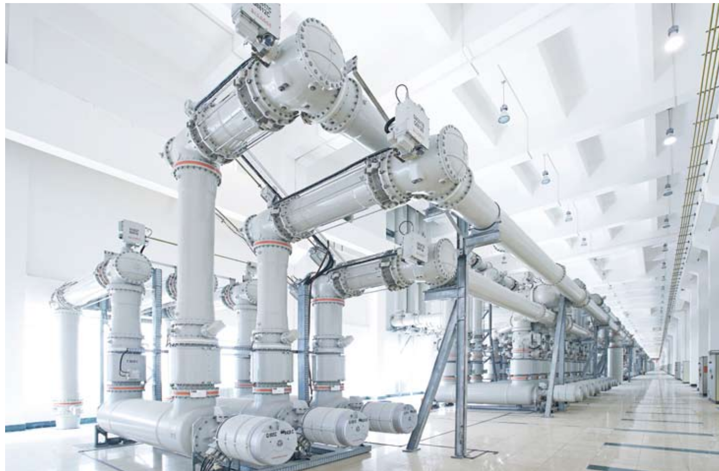
Rozdzielnice wysokiego napięcia typu GIS zwiększają niezawodność i wydłużają żywotność całej instalacji. Dlatego zastosowano je w największej hydroelektrowni świata – chińskiej Zaporze Trzech Przełomów. (Fot. Arch. ABB)
