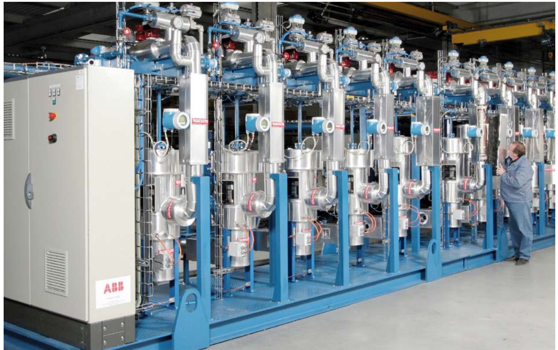
Instalacja In-line Blending. Widoczny system rur i zaworów trójdrożnych pozwala na zamykanie i otwieranie odpowiednich odcinków rurociągu, a tym samym zoptymalizowanie koniecznej do wykorzystania linii przepływu. (Fot. Arch. ABB)
