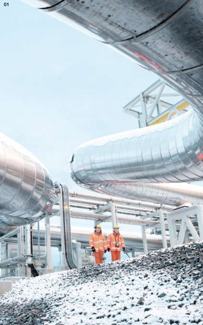
01 Zakłady petrochemiczne to dziesiątki instalacji rozlokowanych na ogromnym obszarze. Nadzór nad cyklem produkcyjnym wymaga szybkiej i bezpiecznej transmisji danych. Zapewnić to może Tropos, dzięki któremu można zbudować również system monitoringu na całym terenie. (Fot. Arch. ABB) 02 Każda kopalnia – jak na przykład Collahuasi w Chile – wykorzystuje na powierzchni drogie i skomplikowane maszyny. Zdalna kontrola i nadzór nad nimi pozwala optymalizować koszty i zwiększyć bezpieczeństwo pracowników. (Fot. Arch. ABB) 03 Systemy szybkiej i bezpiecznej wymiany informacji pozwalają ograniczać koszty operacyjne i zwiększać produktywność wielu gałęzi przemysłu. Również porty i nabrzeża przeładunkowe są w stanie – dzięki systemom typu Tropos – lepiej wykorzystać własną infrastrukturę.
