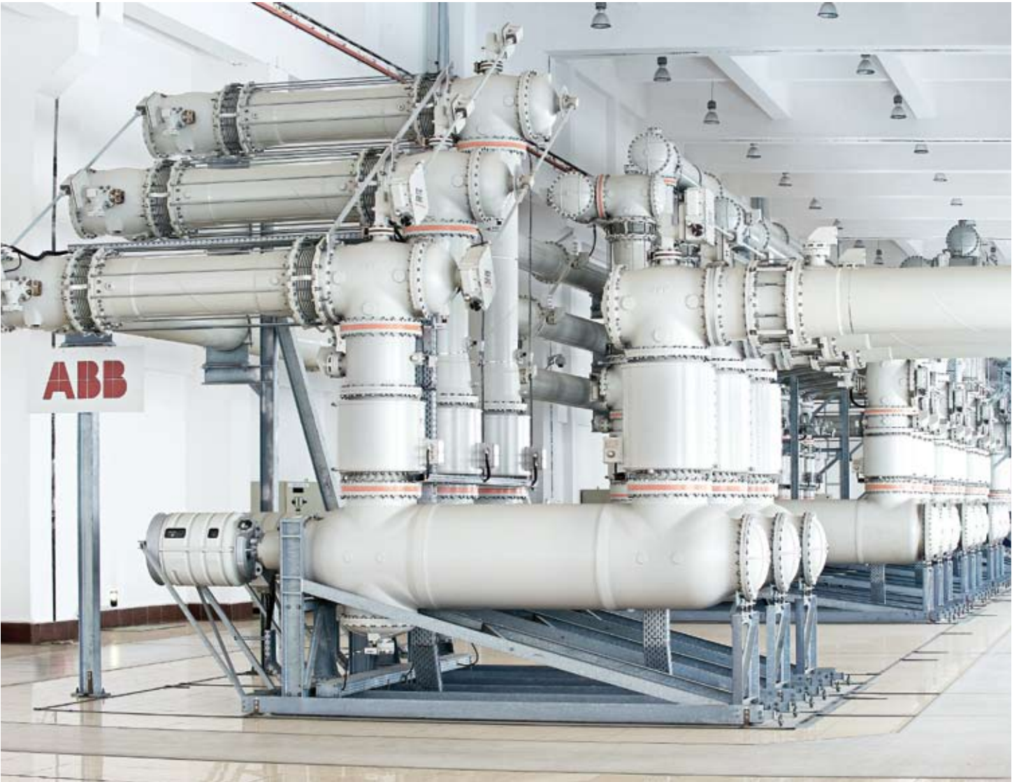
Rozdzielnica wysokiego napięcia typu GIS wyprodukowana przez ABB i zainstalowana w elektrowni na prawym brzegu zapory wodnej Trzech Przełomów w Chinach. Dostarczona na miejsce w 2006 roku rozdzielnica ELK-3 na 550 kV była w tym czasie największą rozdzielnicą w izolacji gazowej na świecie. (Fot. Arch. ABB)
