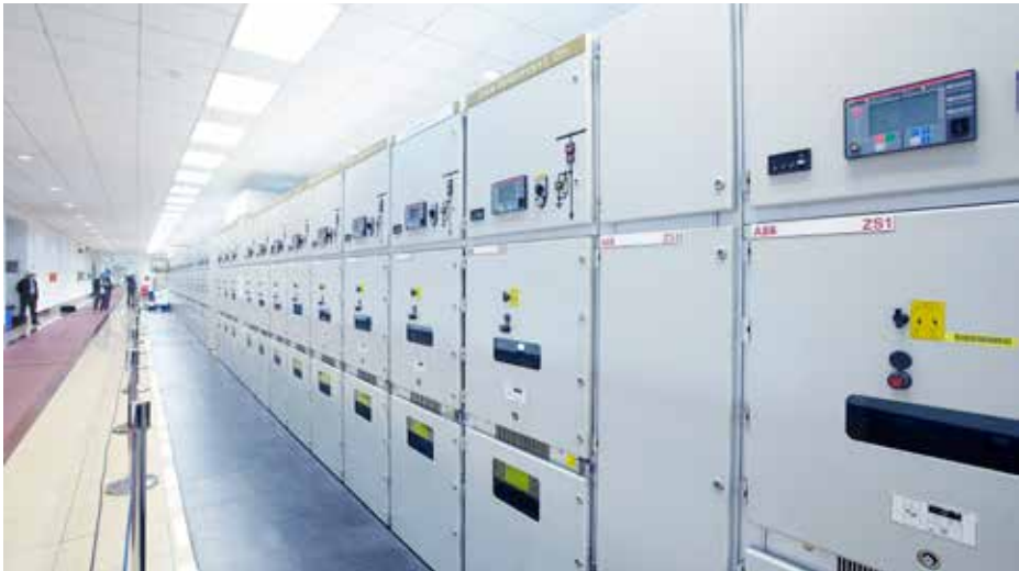
Nowe technologie zostały zaimplementowane również w dobrze znanej i wielokrotnie sprawdzonej konstrukcji rozdzielnic UniGear, dzięki czemu powstała jej zupełnie nowa wersja UniGear Digital, która wyznacza nowe standardy w zakresie niezawodności, zarządzania i kontroli systemu. Pierwsza w Polsce rozdzielnica w standardzie UniGear Digital zostanie wkrótce zainstalowana w jednej z hut szkła.
