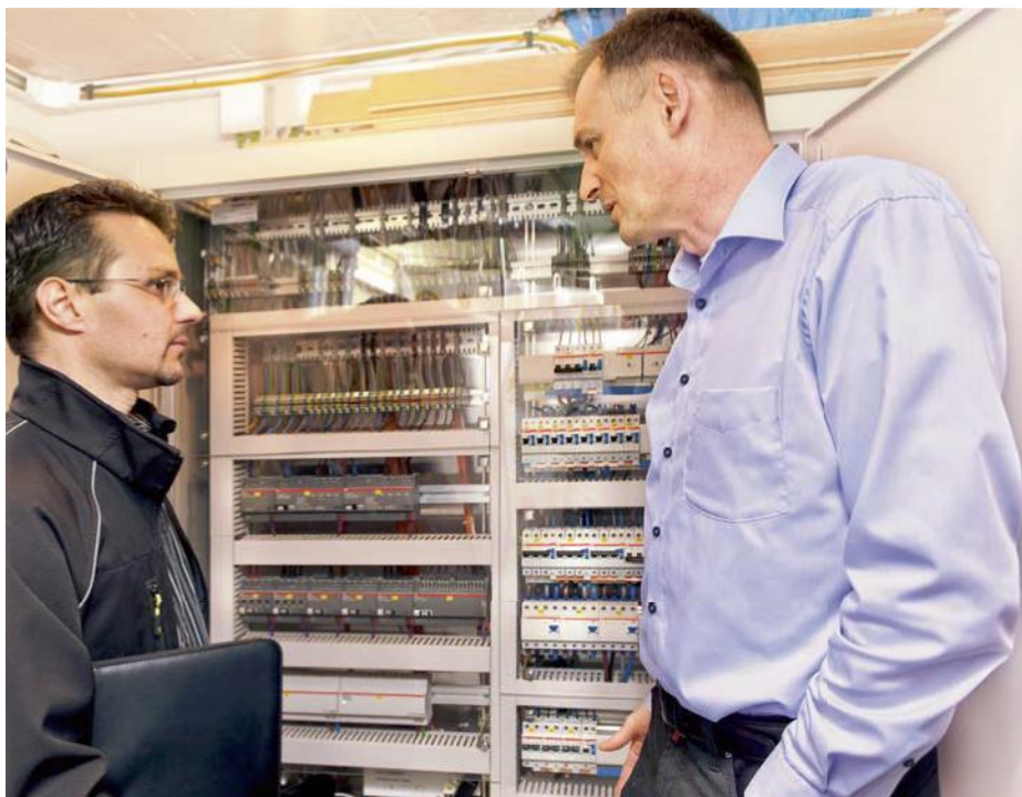
L'installateur électrique Roger Acklin (à gauche) en compagnie de Dieter Kunert devant l'armoire électrique au sous-sol.
