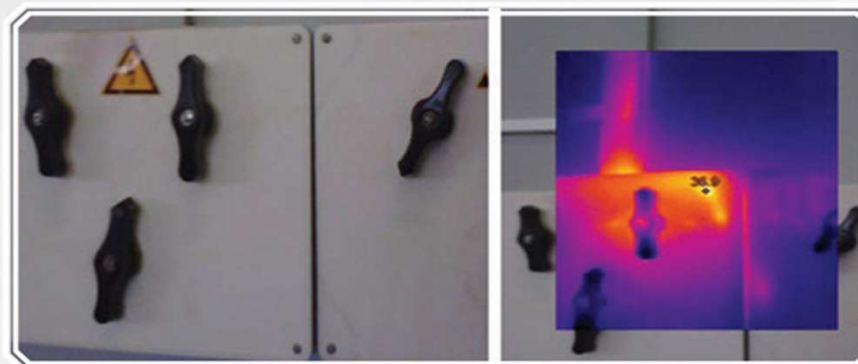
Elektros skirstyklos panelės temperatūra 36 °C. Nustatytas kaistantis automatinis jungiklis ir kontaktai.
