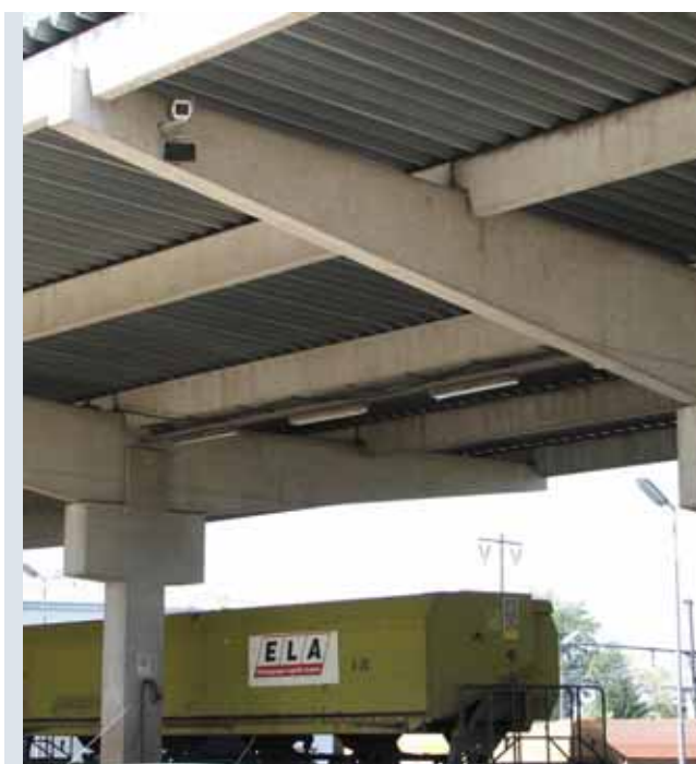
Videoüberwachung inklusive Infrarot-Scheinwerfer im Außenbereich
