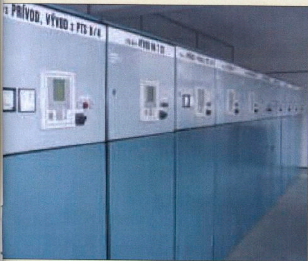
Rekonštruovaná rozvodňa PTS 6
