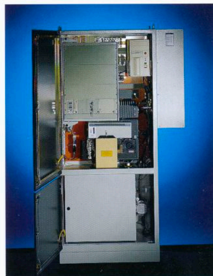
Obr. 2 Emisný monitorovací systém CEMAS FTIR
