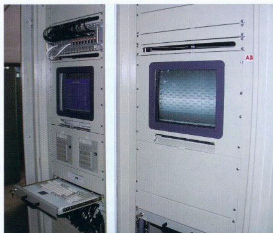
Obr. 3 Zdvojený komunikačný FrontEnd počítač a server riadiaceho systému
