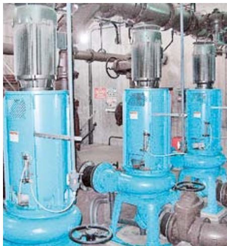
17 Systém čerpania v úpravni vody
