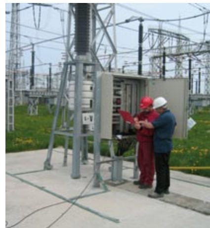
Obr.4 Pravidelná kontrola a funkčné skúšky na VVN vypínači ELF SP
