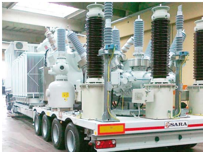
7 Použitie transformátorov TIP pre mobilnú rozvodňu
