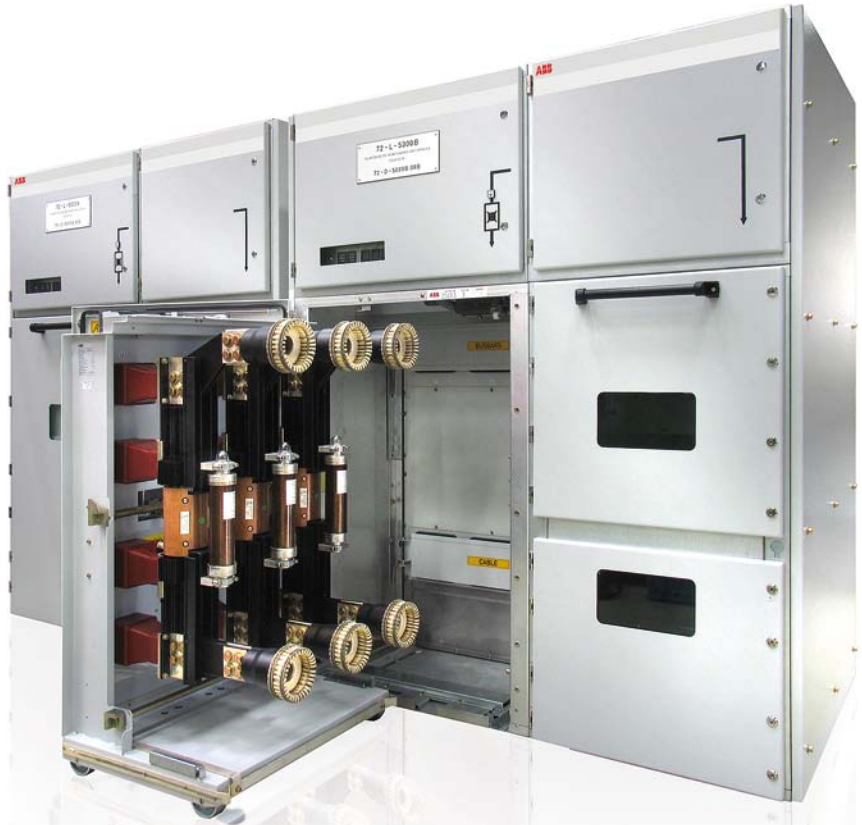
1 I_s -limiter inštalovaný v rozvádzači UniGear ZS1 s elektronickou jednotkou v NN skrinke
