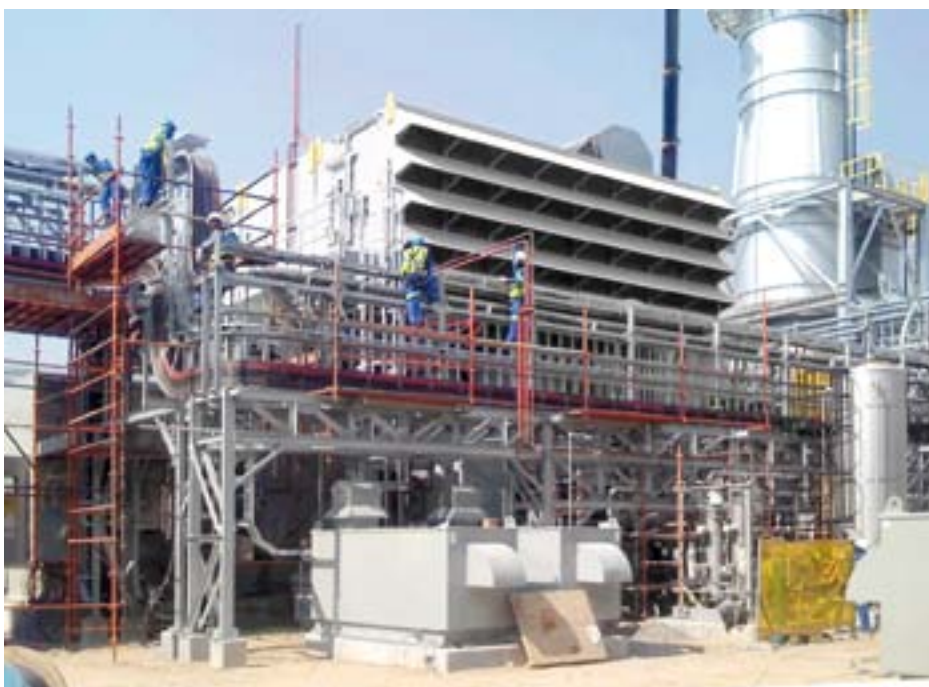
Rozostavaná plynová elektráreň bude po dokončení zásobovať elektrickou energiou baňu Orapa mine.
