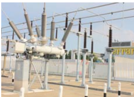
1 PASS M0 SBB, rozvodňa Ferrari, Taliansko
