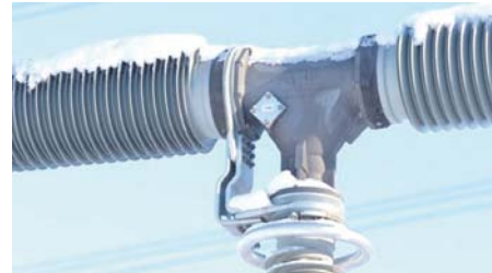
3 FOCs nainštalovaný na 400kV vypínači LTB
