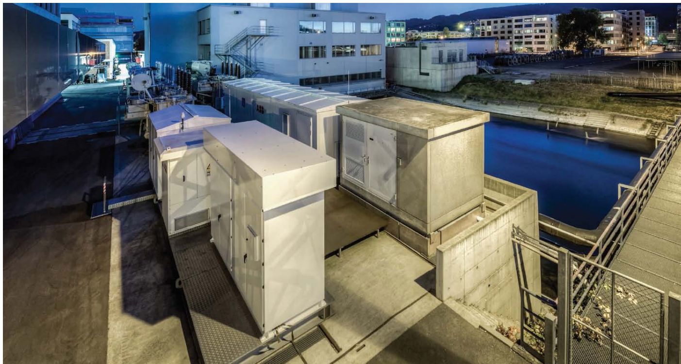
4 Stanica BESS 1 MW prevádzkovaná EKZ Zürich
