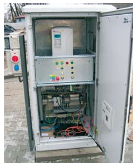
Obr.2 Rozvádzač s meničom ACS 800
