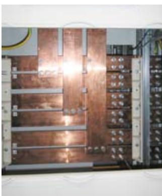
2 Prípojnicový most v rozvádzači
