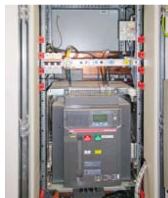
3 Prívodné pole s ističom Emax
