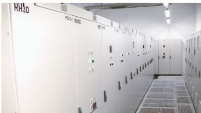
1 Pohľad na rozvádzače
