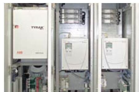
Regulátor TYRAK a nové meniče ABB DCS800 inštalované v prvej fáze projektu.
