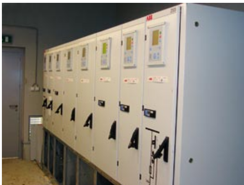
3 VN Rozvodňa M008 – rozvádzač typu ZX0 24 kV, 1250 A, 25 kA
