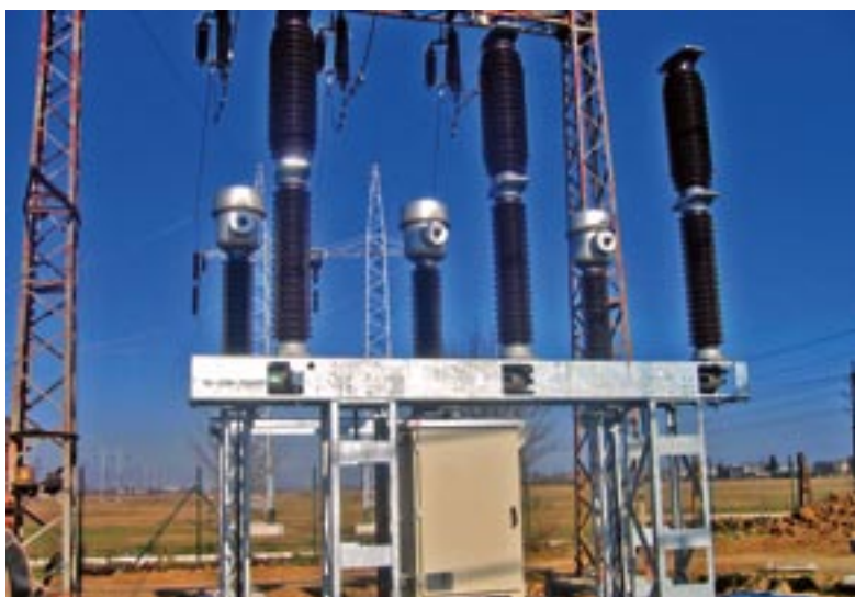
1 Vypínač LTB v elektrickej stanici Haniska
