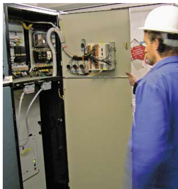
2 Retrofitovaná skriňa rozvádzača 6 kV
