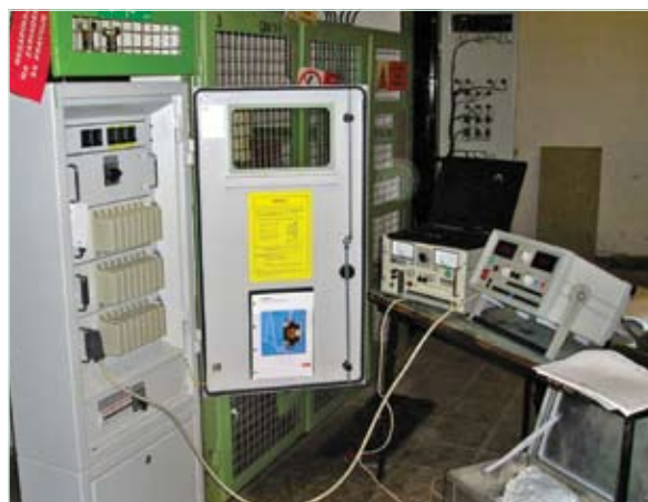
6 Skriňa vypínacej automatiky s testovacím zariadením
