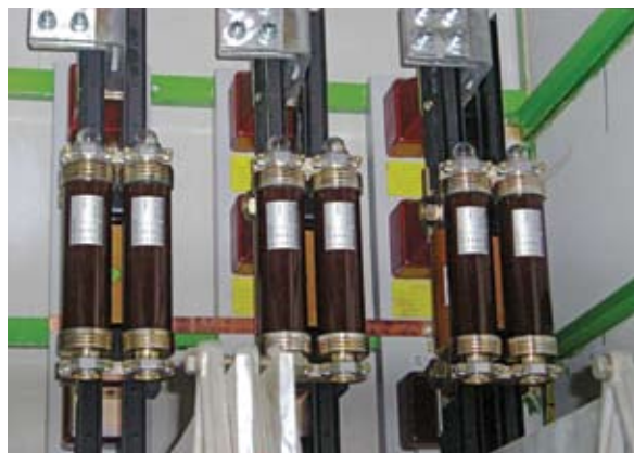
5 Detailnejší pohľad na I_s -limitor v kobke
