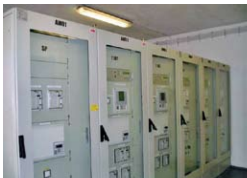
1 Rozvádzače ochrán R 110 kV
