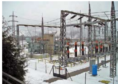
2 Rozvodňa R 100 kV
