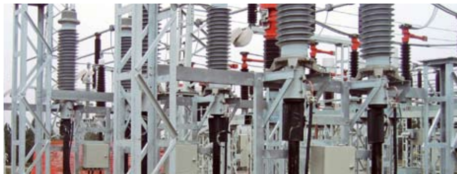
Obr. ES Križovany – 110 kV kábel s vyvedením optického vlákna
