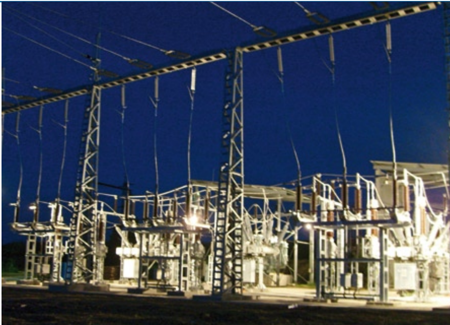
Obr.2 Nočný pohľad na rozvodňu 110 kV
