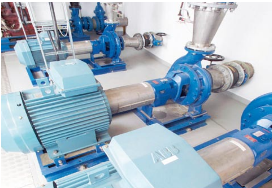
2 Frekvenčné meniče ACS310 a ACQ810 sú ideálnou voľbou pre vodárenské aplikácie. Navrhnuté sú tak, aby riadili jedno alebo viac čerpadiel. Na obrázku je pohľad na aplikáciu kaskádového riadenia čerpadiel zásobníkov pitnej vody
