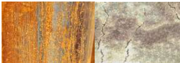
2. ábra: Lemezállomásokon megjelenő korrózió és betonállomásokon megjelenő repedések
