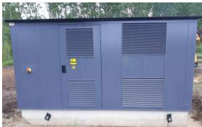
1. ábra: Magyarországon telepített ABB Spica 20 típusú GRP 1600 kVA-es transzformátorállomás
