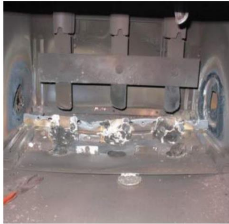
Compartimiento de cables
