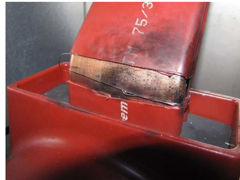
Punto de iniciación de falla
