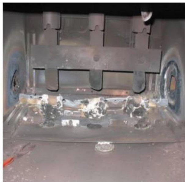
Compartimiento de cables
