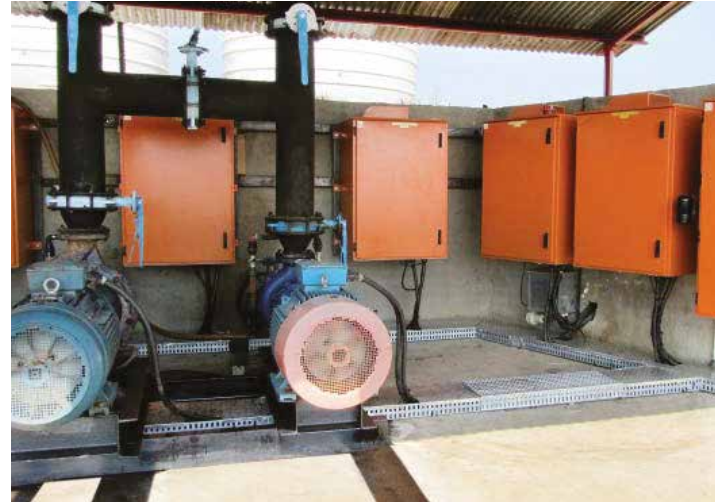
การลงทุนใช้งานไดร์ฟสามารถคืนทุนได้ภายใน 7 เดือน และประหยัดพลังงานได้ 40% โดยการใช้งานร่วมกับมอเตอร์เดิมที่มีใช้งานอยู่แล้ว
