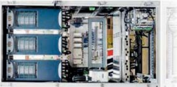
รูปที่ 5A ABB's EssPro PCS c600 ติดตั้งในอาคาร
