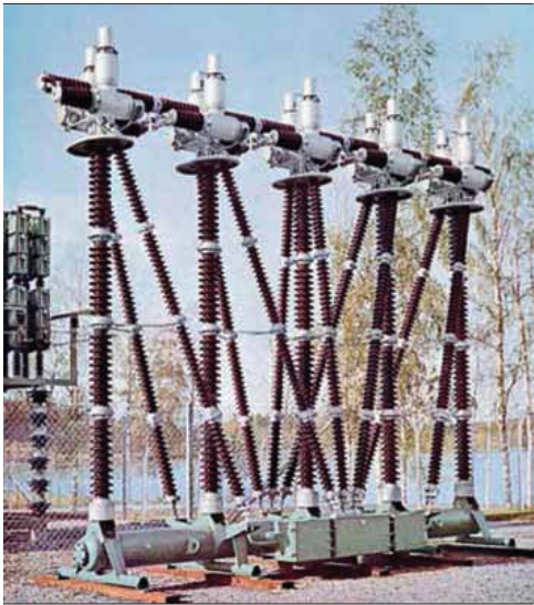
รูปที่ 3 เซอร์กิตเบรกเกอร์แบบเทคโนโลยี Airblast ที่แรงดัน 420 kV ในปี 1955 ด้วยตัวตัดกระแส 10 ยูนิต์ต่ออุโมงค์กัน
