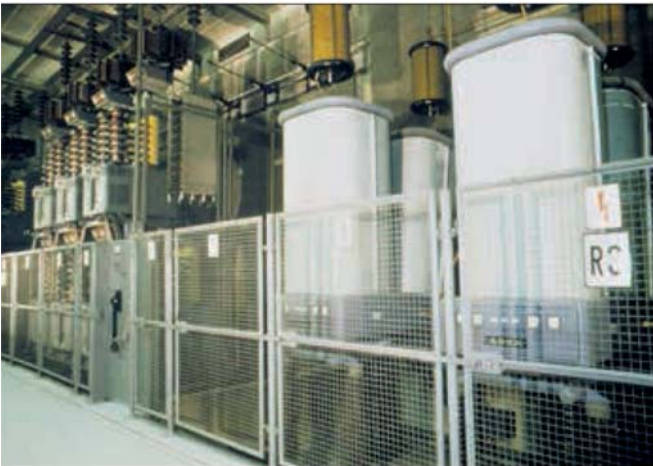
รูปที่ 4 วาล์วชนิด Mercury-arc และวาล์วชนิดไทรสเตอร์ได้ถูกติดตั้งที่ Gotland 1
