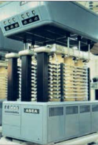
รูปที่ 3 วาล์วชนิด Mercury-arc ของ Pacific Intertie สำหรับที่เมือง Sylmar, Los Angeles
