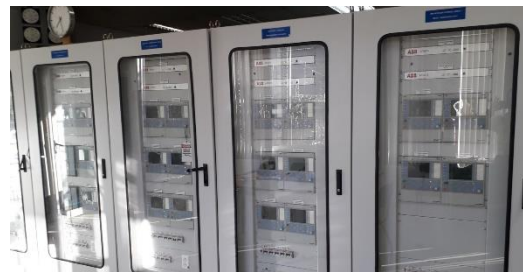
Fig. 14 Tableros instalados en la sala eléctrica
