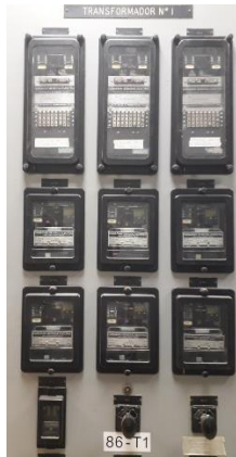
Fig. 1 Relés electromecánicos S/E Vicentina
