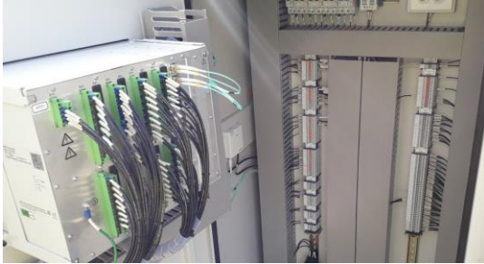
Fig. 16 Merging Unit de la bahía de transformador
