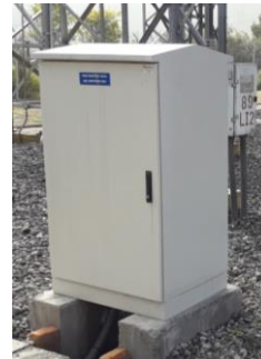
Fig. 9 Merging Units ubicadas en patio de 138kV
