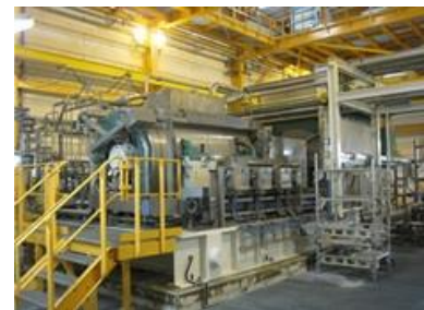
Compresor en la planta de Statoil en Kollsnes (Fuente: Statoil)
