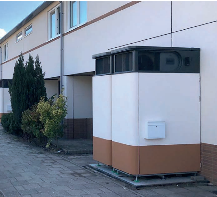
— Geïnstalleerde energiemodule met warmtepomp; elke woning zijn eigen module
